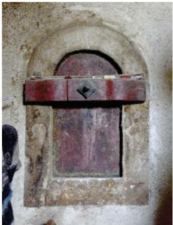
Boca d'home de la tina d'obra.
